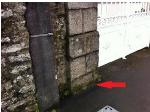
Sol au droit du poteau du portail d'entrée
