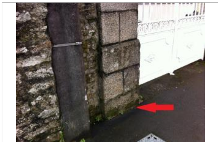
Sol au droit du poteau du portail d'entrée
