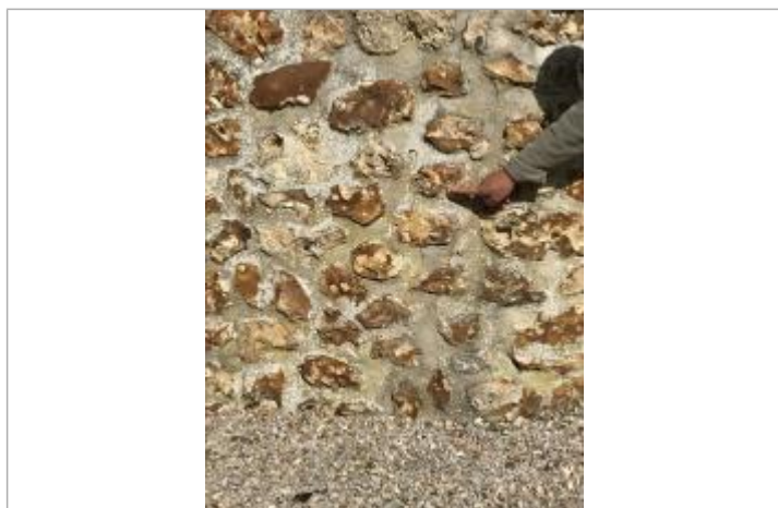
Niveau d'eau atteint sur le mur du pignon nord-est de la maison
