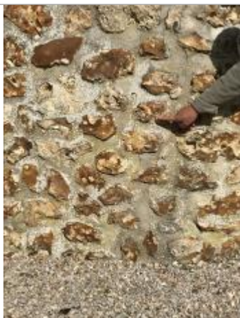
Niveau d'eau atteint sur le mur du pignon nord-est de la maison
