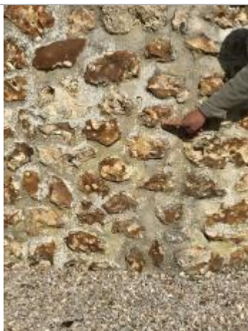
Niveau d'eau atteint sur le mur du pignon nord-est de la maison
