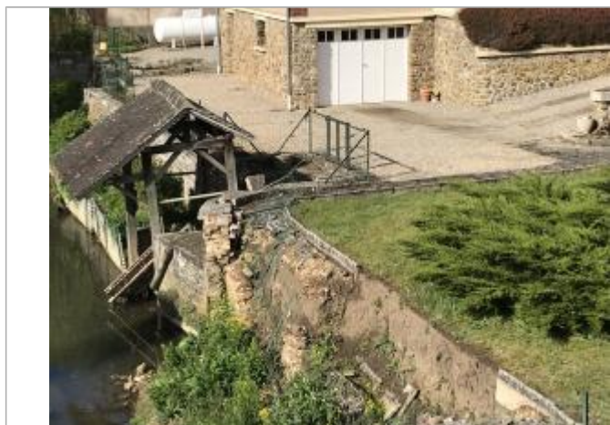
Traces au sol de la coulée de boue en provenance du chemin de la cavée
