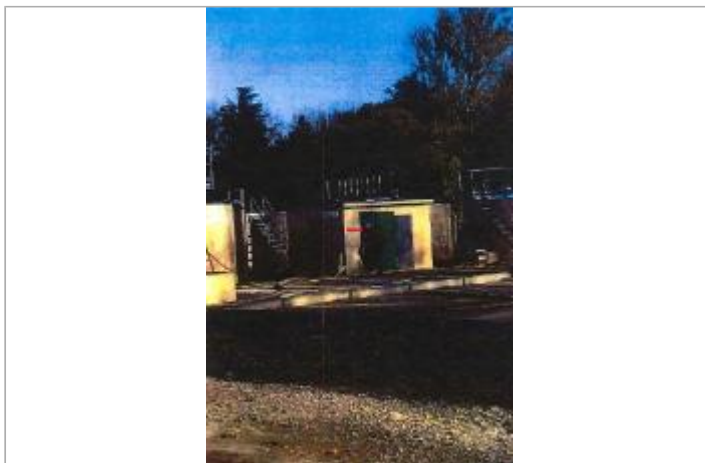
Mur du local technique
