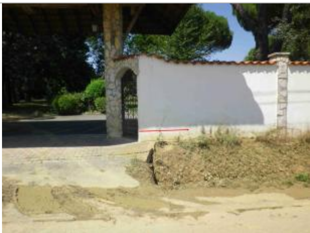
Vue de la laisse d'inondation - Auteur : GEOSPHAIR
