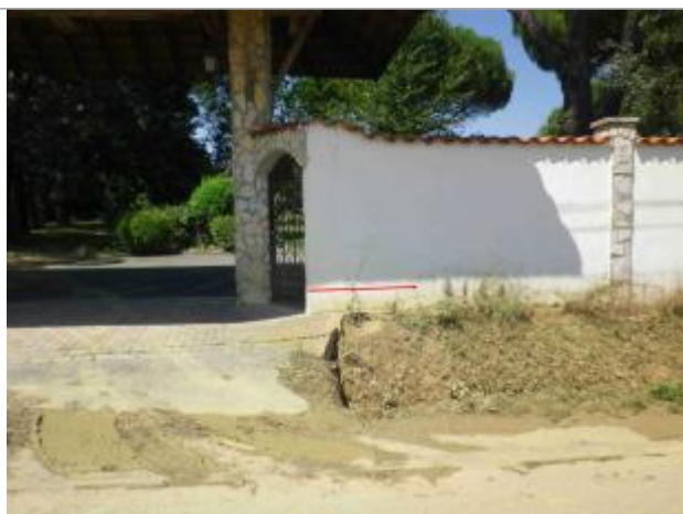
Vue de la laisse d'inondation - Auteur : GEOSPHAIR
