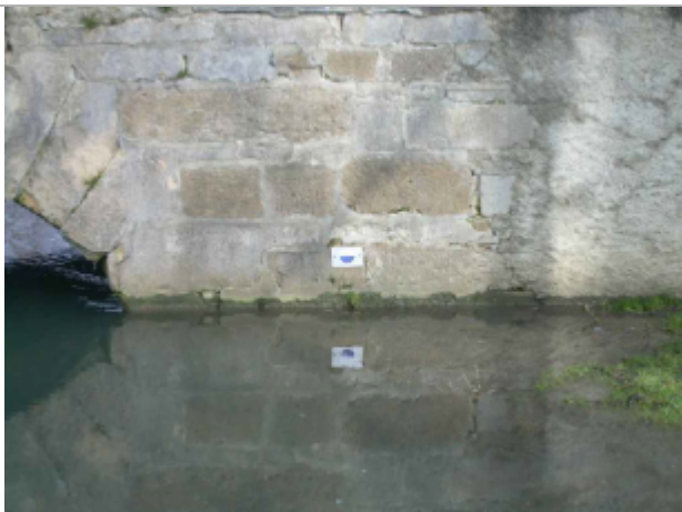
repere de crue au centre de la photo
