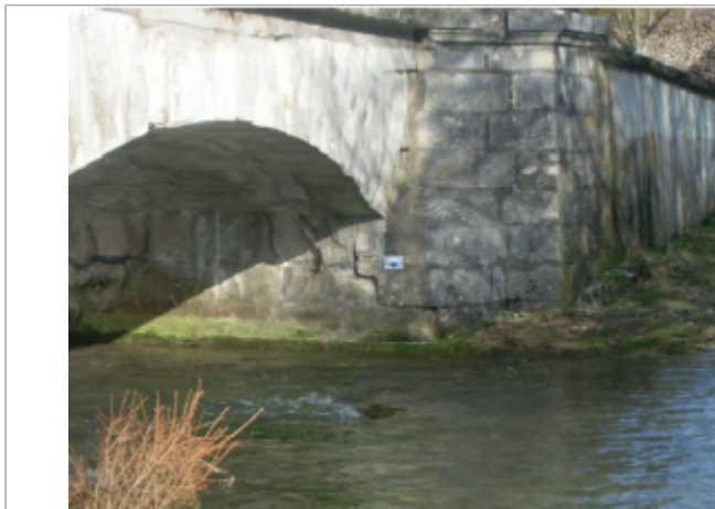
Repere de crue au centre de la photo
