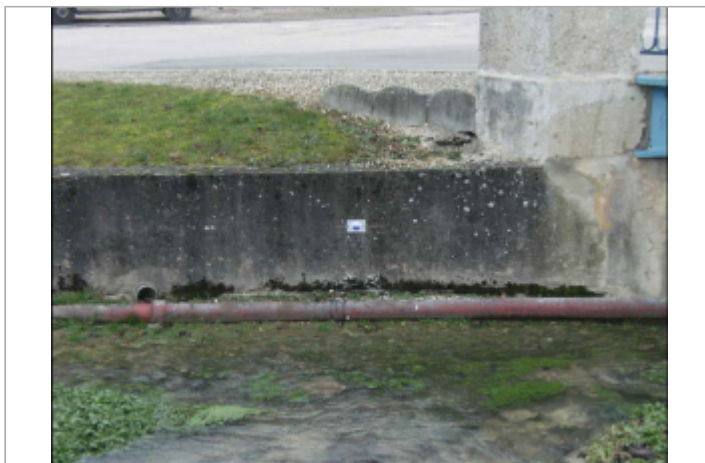
Repere de crue au centre de la photo
