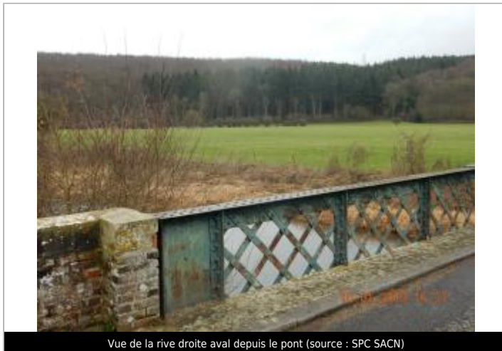
Vue de la rive droite aval depuis le pont (source : SPC SACN)
