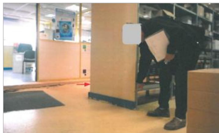
Laisse de crue à 25 cm/ sol. (photo SPC SACN)
