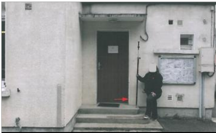
Laisse de crue à 20 cm/sol. (photo Laboratoire CEREMA Normandie-Centre de Blois)
