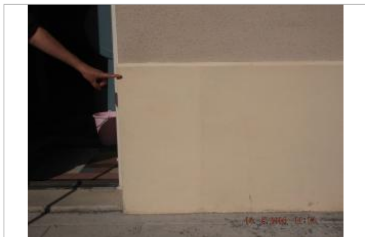
Laisse de crue sur mur façade Ouest
