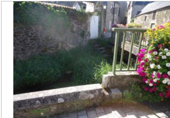
Muret pont de la rue de la Triballe - Source : SMAP, 2018
