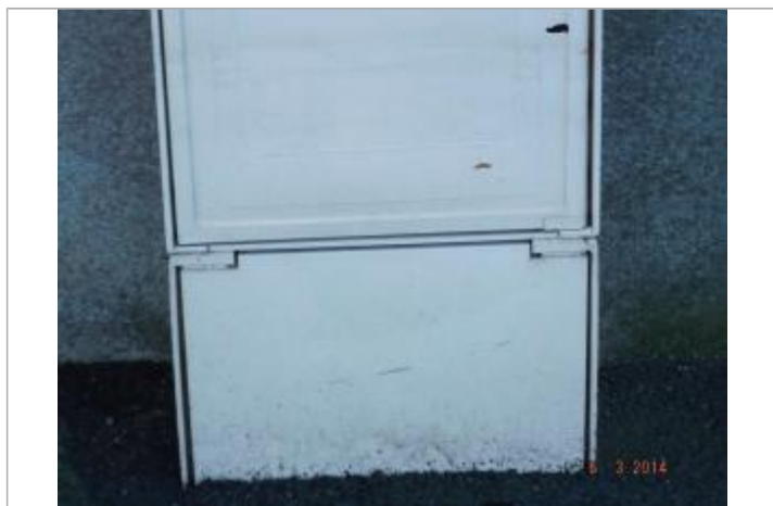
Marque sur le coffret EDF - Source : DDTM 22
