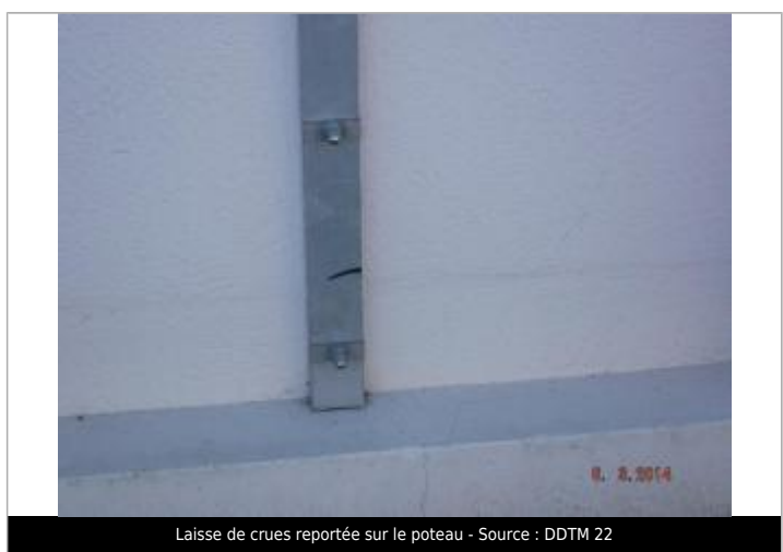
Laisse de crues reportée sur le poteau - Source : DDTM 22
