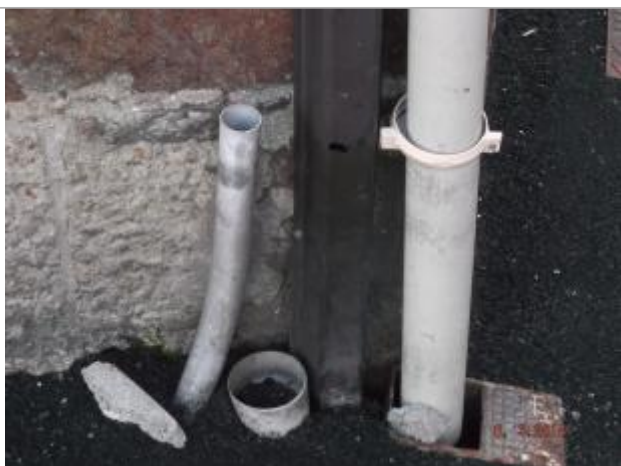
Laisse de crues sur le bâtiment, à l'angle - Source : DDTM 22
