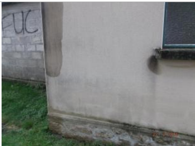
Laisse de crues mur réserve - Source : DDTM 22
