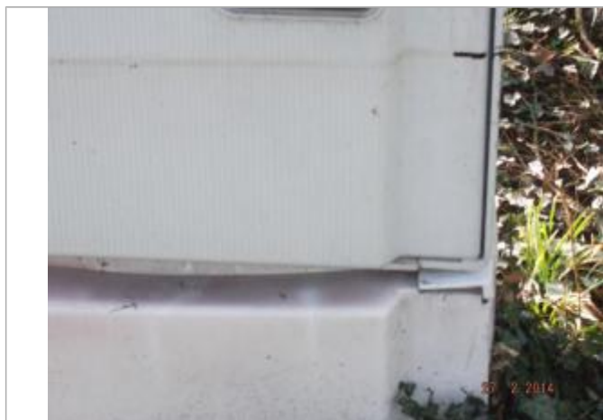
Laisse de crues, poste de refoulement - Source : DDTM 22
