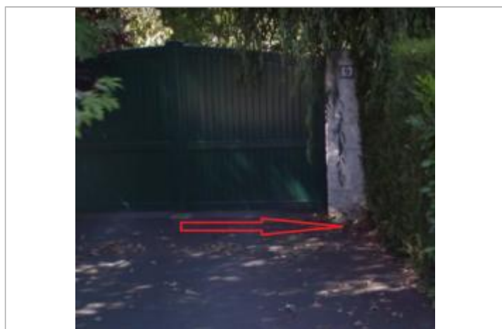
sol au pied du poteau droit du portail d'entrée
