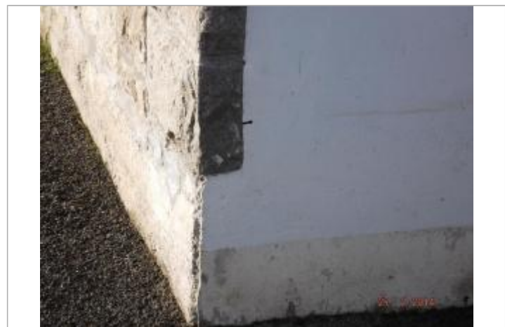
LdC mur - Source : DDTM 22
