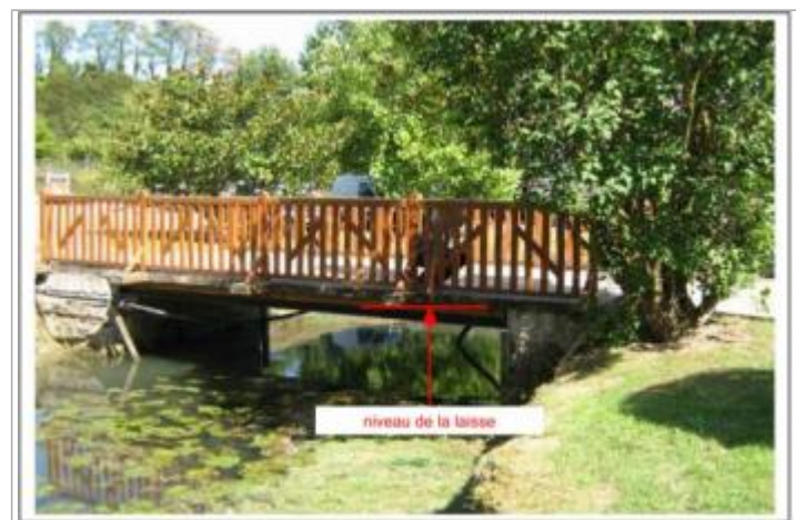
Repère de 2001 (source : CEREMA, 2008)
