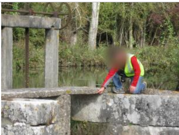
Repère de 2001 (source : CEREMA, 2008)
