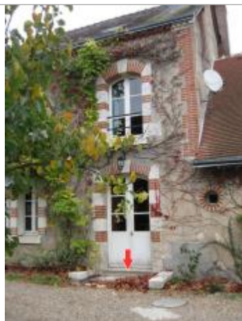
Repère de 2001 (source : CEREMA, 2008)
