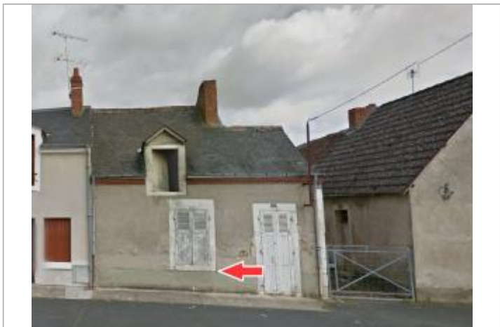
Vue du repère (source : CETÉ Normandie-Centre)
