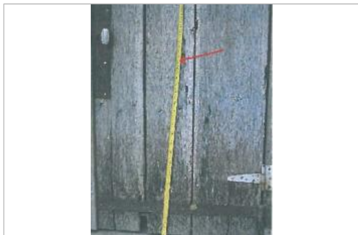
Vue du repère (source : CETE Normandie-Centre)
