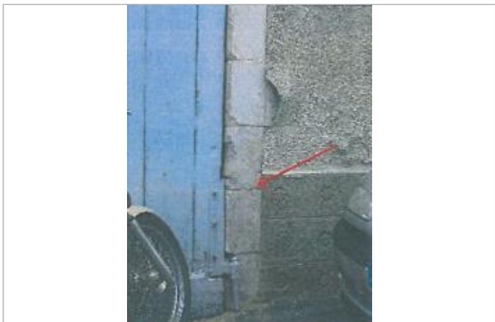
Vue du repère (source : CETE Normandie-Centre)
