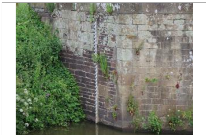
Echelle limnimétrique à l'aval de l'écluse de Cicé à Bruz
