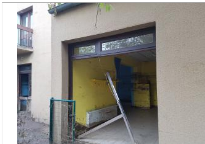
Traces de boue indiquant le niveau maxi
