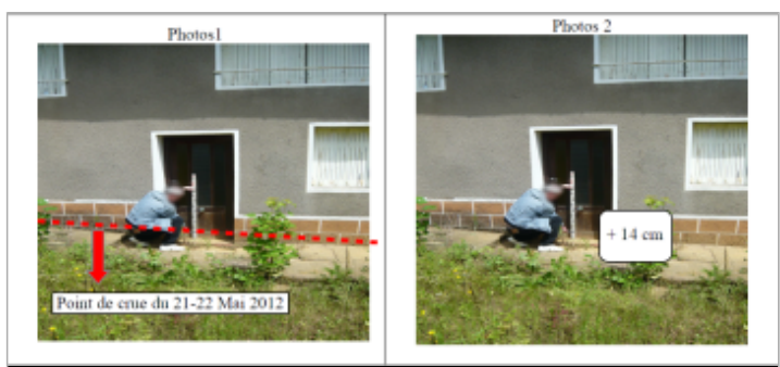
Trace du maximum de la crue sur la porte de l'ancien Moulin route de Laitre sous Amance
