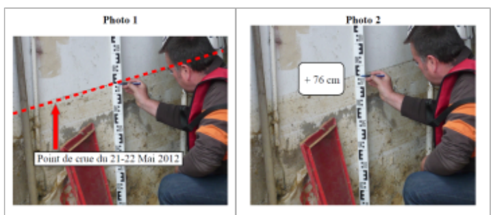
Trace sur le mur à l'intérieur de la maison
