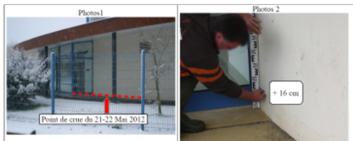
Trace du maximum de la crue sur la façade de la salle des fetes
