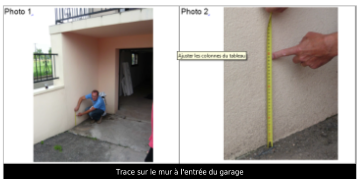
Trace sur le mur à l'entrée du garage
