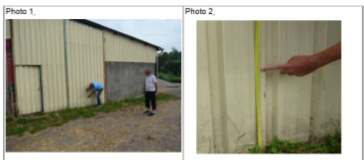
Trace sur le bardage du hangar
