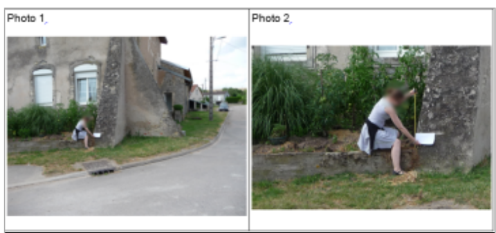
Trace du maximum de la crue sur le pilier de soutènement du 5 Grande Rue
