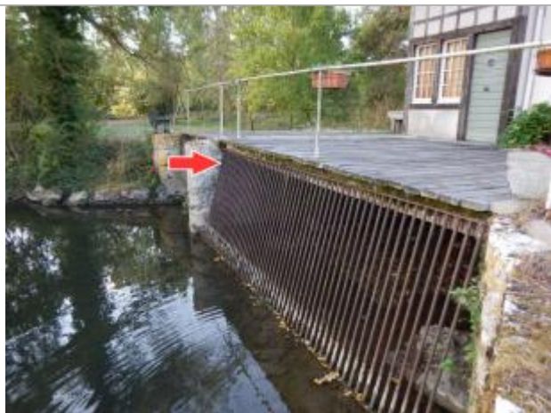
Repère de la crue de juin 2016 (source : SPC LCI)
