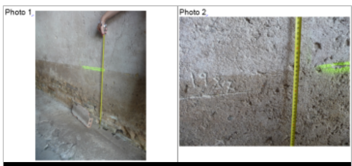
trace du maximum de la crue sur le crépis ciment au 6 place de l'église
