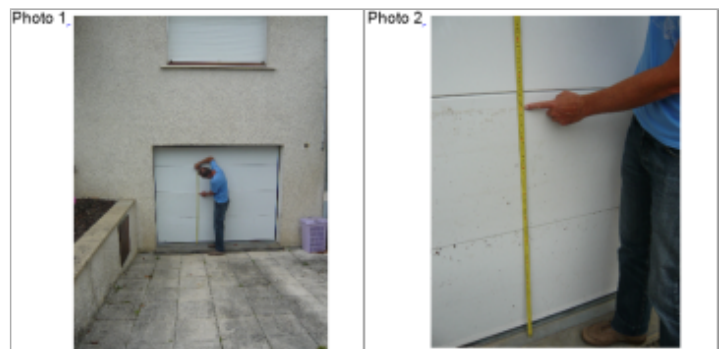
Trace du maximum de la crue sur la porte du garage au 10 rue du Chateau
