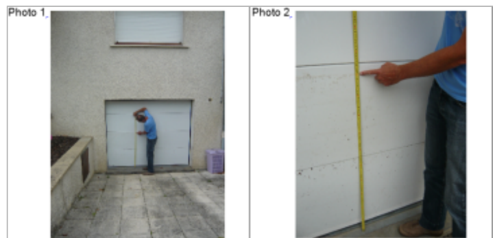
Trace du maximum de la crue sur la porte du garage au 10 rue du Chateau
