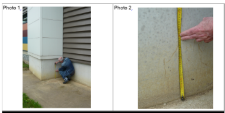
Trace sur le sous bassement du bâtiment
