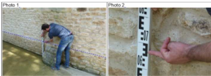
Trace du maximum de la crue sur le mur en pierres coté amont face à la rivière
