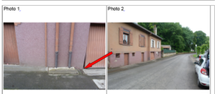
Limite inondation à l'entrée du garage du 8 rue du Moulin
