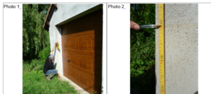
Trace du maximum de la crue sur la façade de la maison à l'angle de la rue de la Fontaine et du chemin rural
