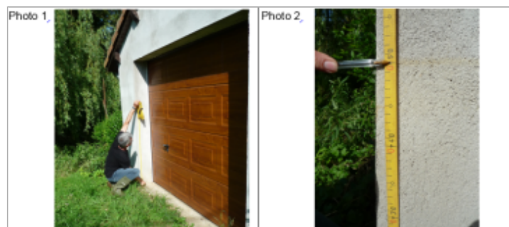
Trace du maximum de la crue sur la façade de la maison à l'angle de la rue de la Fontaine et du chemin rural
