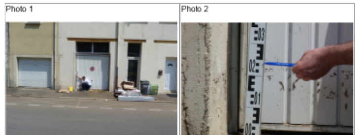
Trace du maximum de la crue sur la façade et la porte de garage du 11 rue de la filature
