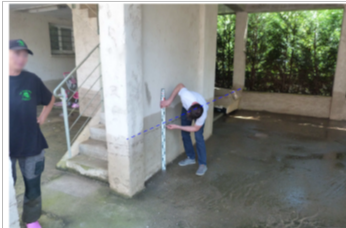
Trace sur le mur béton
