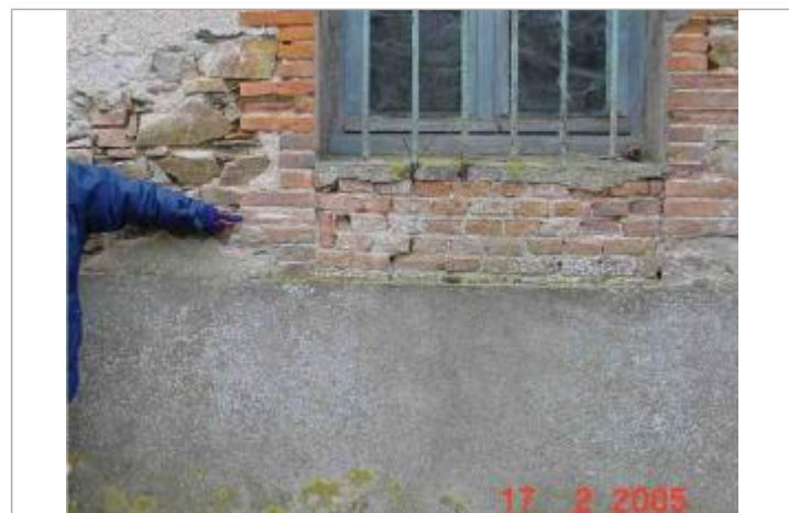
Atlas des Zones Inondables de l'Evre - Laboratoire Régional des Ponts et Chaussées d'Angers - DDT49
