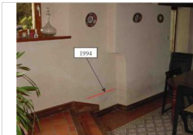
Atlas des Zones Inondables de l'Hyrôme - Laboratoire Régional des Ponts et Chaussées d'Angers - DDT49
