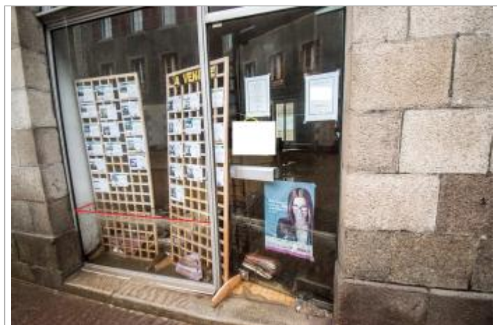
Laisse de crue sur la vitrine du 21 rue de Paris - 01
