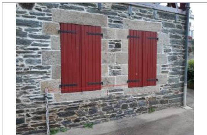
Laisse de crue sur volets à l'arrière du bâtiment
